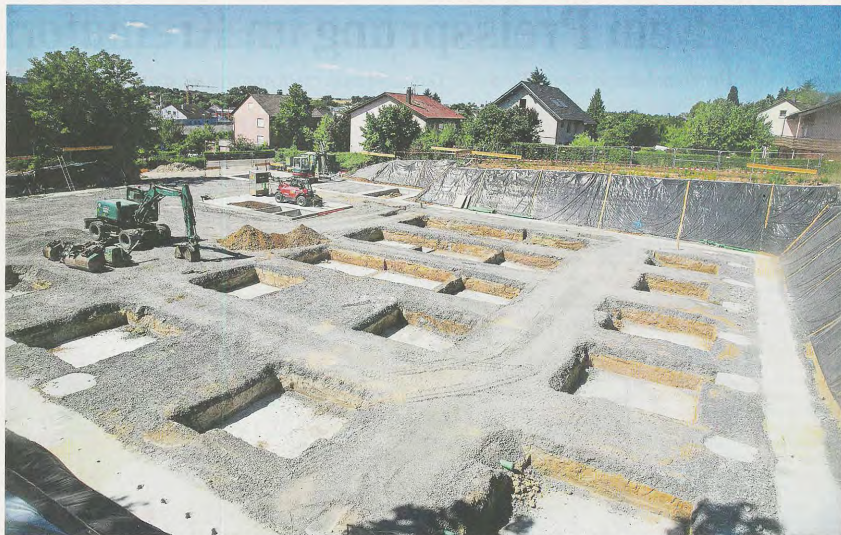
Die Arbeiten am neuen Gesundheitscampus sind in vollem Gange. Momentan wird die Tiefgarage gebaut, Ende 2023 soll das Gebäude bezugsfertig sein.
